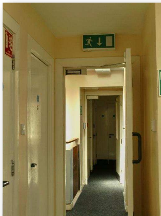
3. kép: Az emeleti folyosó, tűzzáró ajtók
